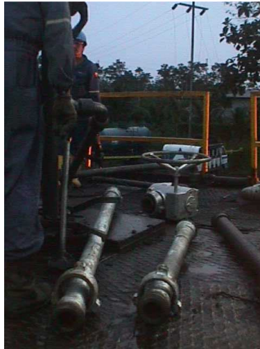
Fig. 3.3 Línea de alta presión
