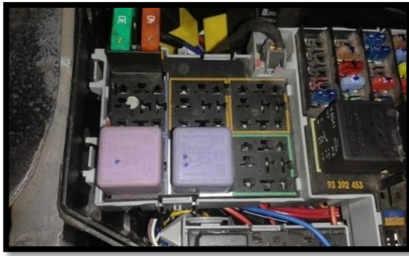
Figura 69. Fusiblera abierta, relé de bomba de combustible.
