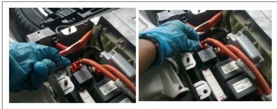
Figura 93. Verificación del bloque de empalme de la batería HV
