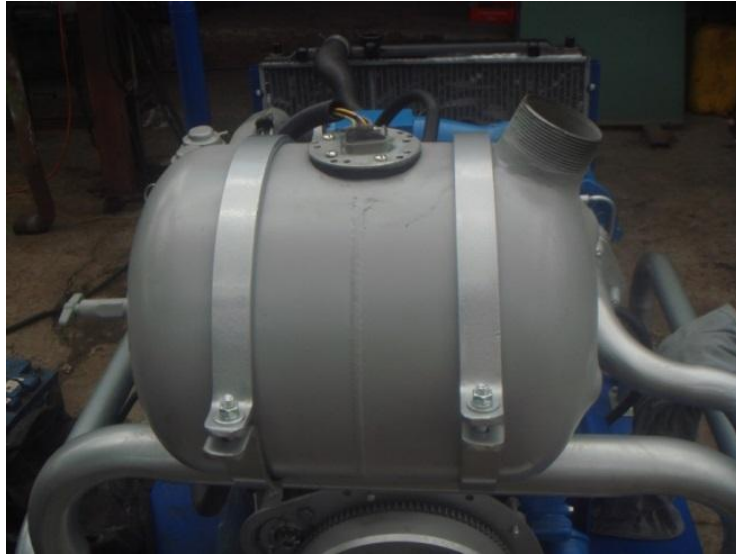
Figura 73. Tanque reservorio de combustible del motor
