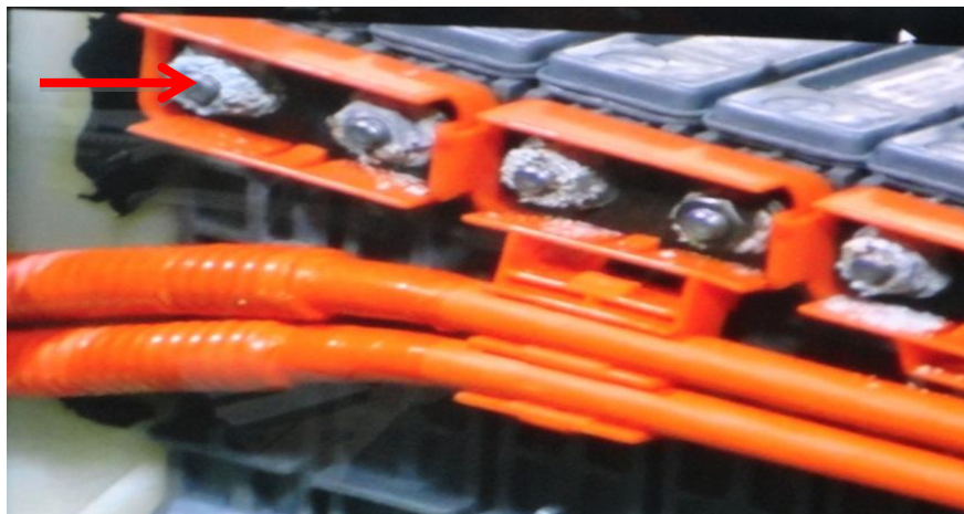
Ilustración 27: Oxido en las placas de cobre.
