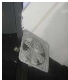
Instalaciones de aire acondicionado y de sonido, equipamiento viejo y dañado .
