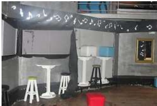
Pista de baile de área club. Paredes despintadas y pisos sucios.
