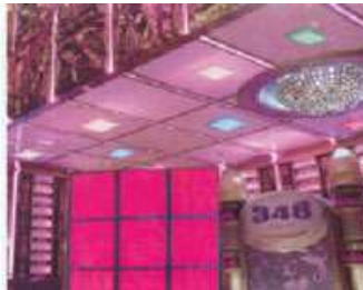
Imagen No. 32 LUMINARIA PAV 500 RGB EN TECHO
