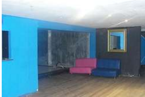
Sala de área club. Paredes despintadas y cables de instalaciones electricas vistas en paredes.
