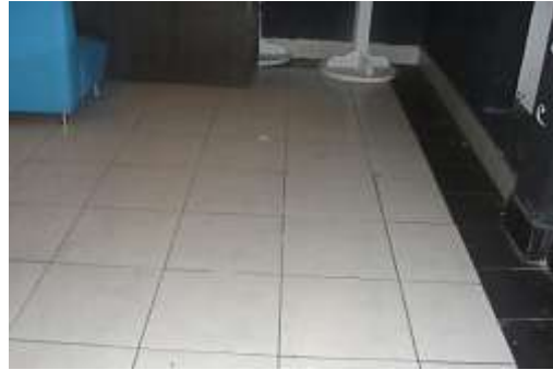
Piso de área club N +0.34, este se encuentra viejo y sucio.
