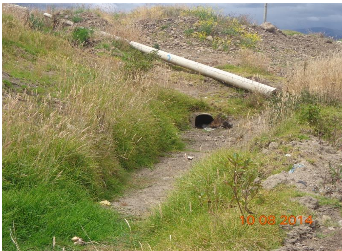
Figura 19. Foto de tubería semi enterrada para el drenaje de aguas lluvias
