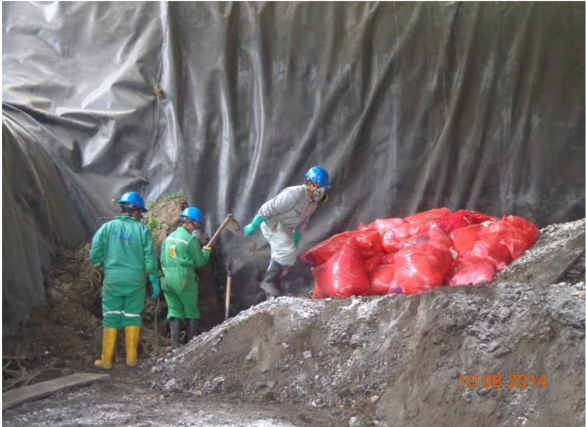
Figura 16. Foto de la parte interna de la celda de residuos hospitalario Daisy Méndez
