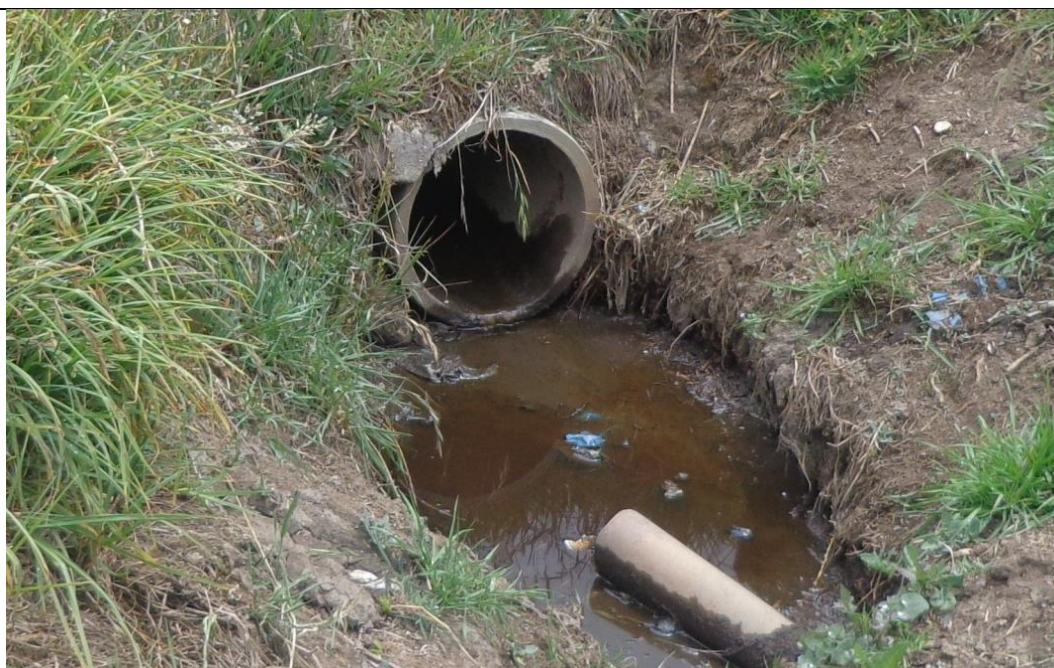
Figura 28. Foto del sistema de aguas lluvias
