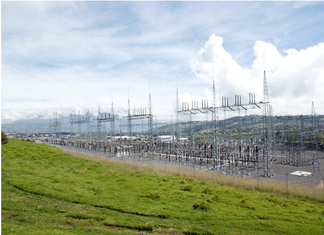
Figura 5. Subestación Santa Rosa
