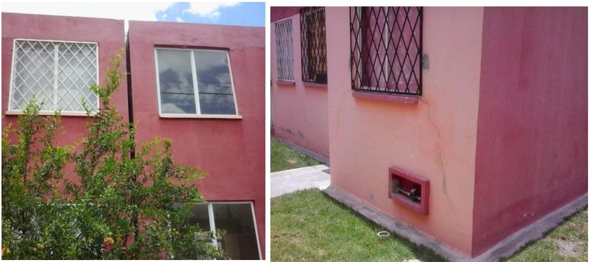
3.4. Fisuras entre viviendas
