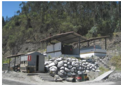
Figura 40. Generadores eléctricos y tanque de diésel para los procesos de trituración
