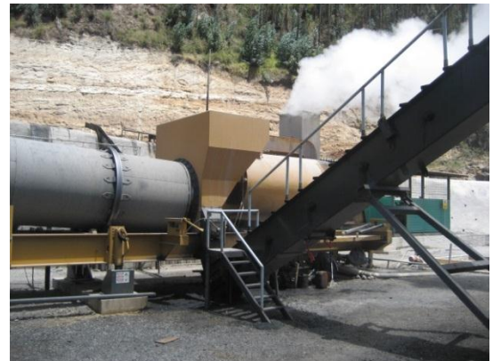
Emanación de gases de la planta asfáltica
