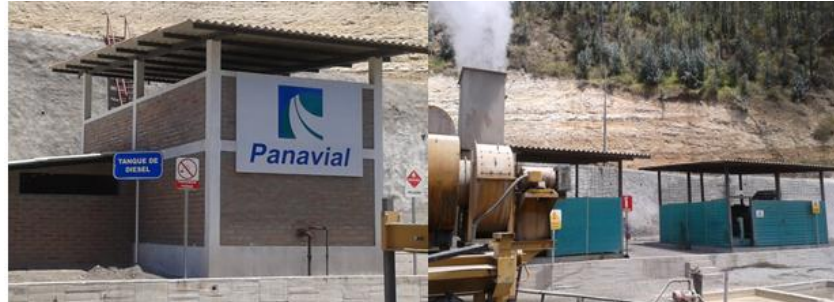
Figura 43. Tanque de diésel y generadores eléctricos para planta asfáltica
