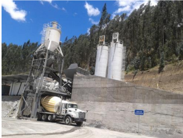
Figura 31. Planta de hormigón de la empresa Panavial S.A.- H.C.C.
