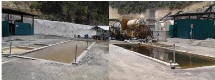
Figura 50. Plantas de tratamiento de agua
