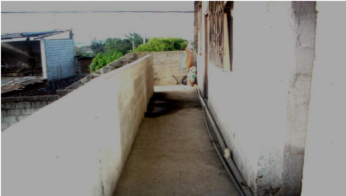
Foto tomada el miércoles 22/07/09 por Lcdo. Eduardo Solórzano, en esta imagen se observa el corredor para ingresar a las aulas del 2do. Piso.
