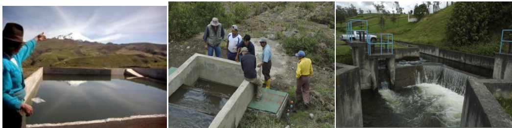
Fig. 6.4.6 Almacenamiento y distribución del agua.
