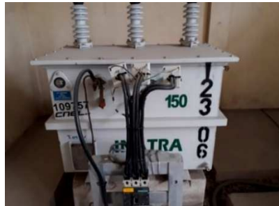
Figura 19. Transformador Trifásico N.2
