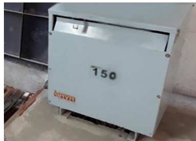
Figura 21. Autotransformador de bajo voltaje
