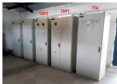
Figura 22. Tablero de Transferencia Automática TTA
