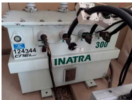
Figura 18. Transformador Trifásico N.1
