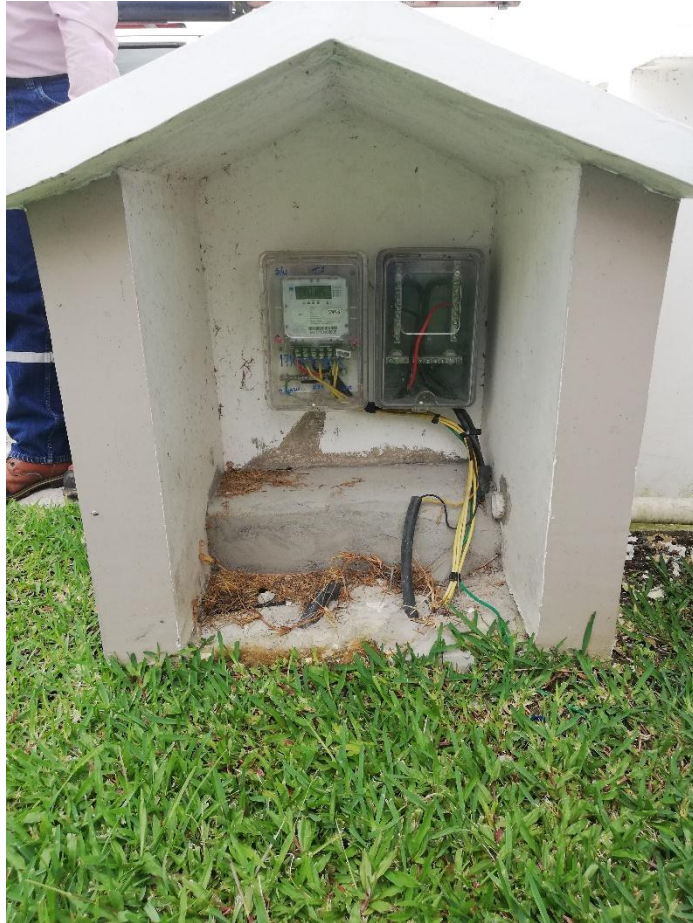
Figura 37. Chequeo medidor RF instalado 4
