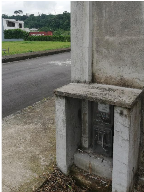
Figura 36. Chequeo de Medidor RF instalado 3
