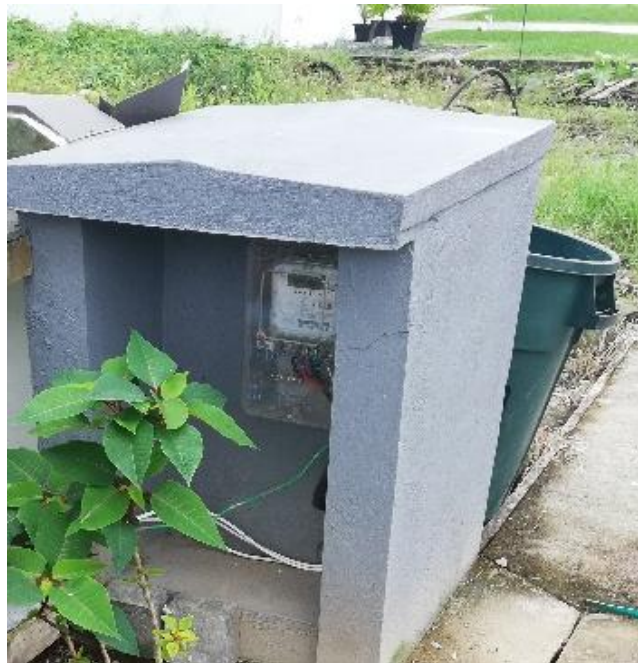
Figura 38. Chequeo medidor RF instalado 5
