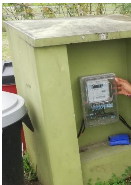
Figura 34. Chequeo de Medidor RF instalado 1
