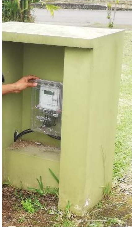
Figura 35. Chequeo de Medidor RF instalado 2
