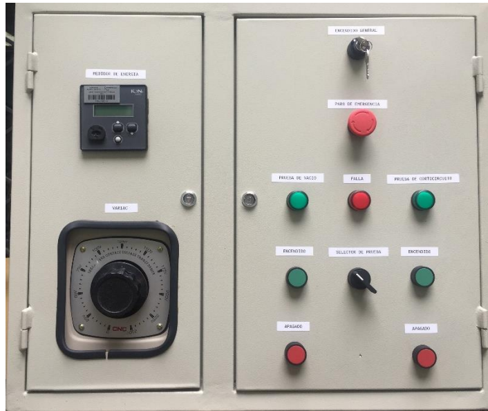
Figura 26. Tablero eléctrico de pruebas de vacío y de cortocircuito.
