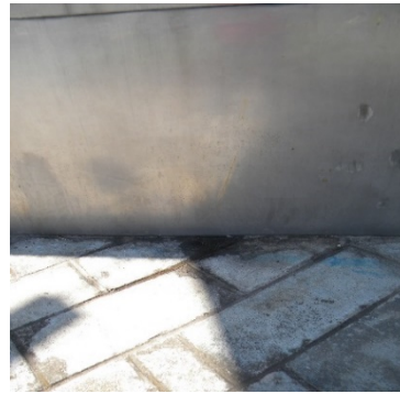
Detalle de orine sobre planchas y en piso-plataforma
