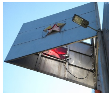
Estrellas –reflectores y Cableado caído
