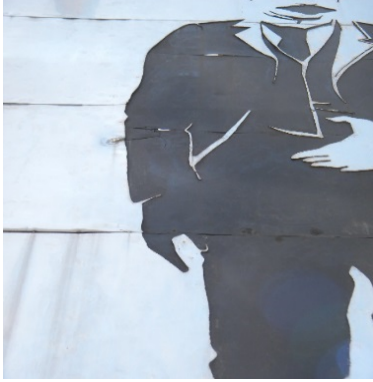
Roturas en cobre y soldada anteriormente.
