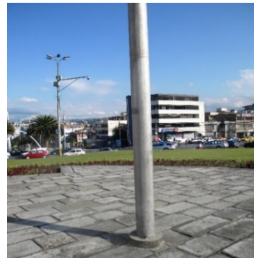
En columnas soportantes .Detalle de smog, grasa, sales, musgo, microorganismos sobre plataforma y canales
