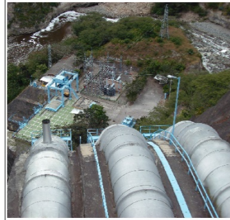
Central hidroeléctrica Nayón
