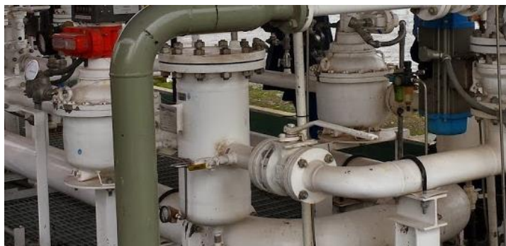
Figura 11 Válvula de seguridad Unidad LACT Estación Paraíso
