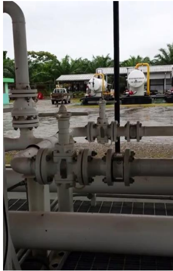
Figura 16 Válvula Check Unidad LACT Estación Paraíso
