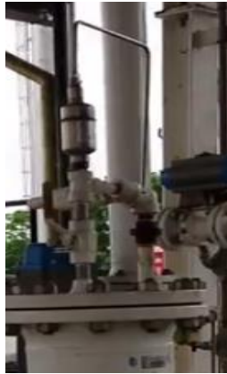
Figura 13 Desaerador Unidad LACT Estación Paraíso
