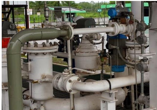
Figura 10 Válvula de 3 vías (rechazo) Unidad LACT Estación Paraíso
