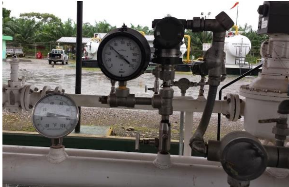
Figura 15 Transmisores de Presión y Temperatura Unidad LACT Estación Paraíso
