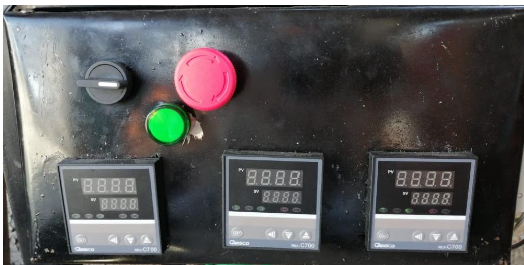
Figura 37. Tablero de control
