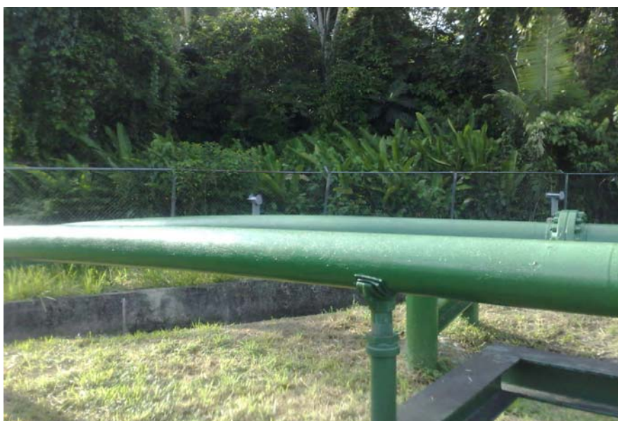
Foto 05. Tubería con Pintura Anticorrosiva Bloque 15 – Complejo ILYP
