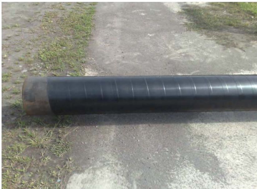
Foto 04. Tubería con Protección Mecánica Bloque 15 – Complejo ILYP
