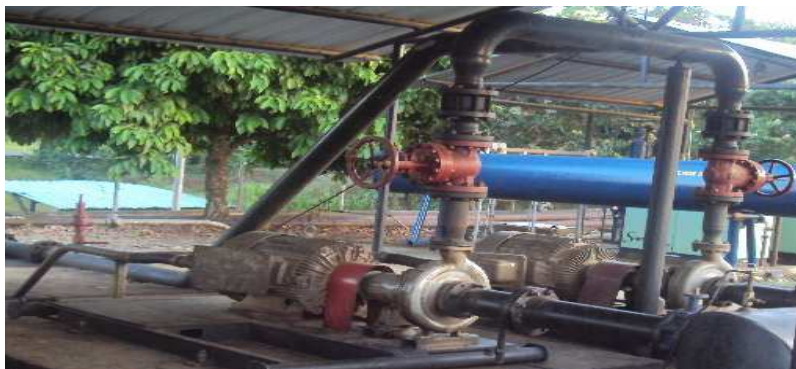
Figura 3.3 Bombas Booster, Estación Atacapi
