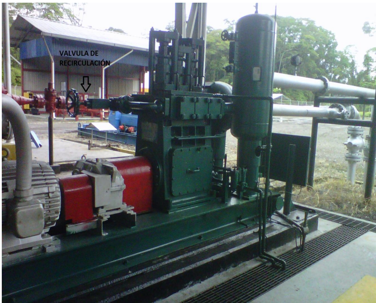
Figura 3.36 Bombas Triplex de Marca Wortinthong
