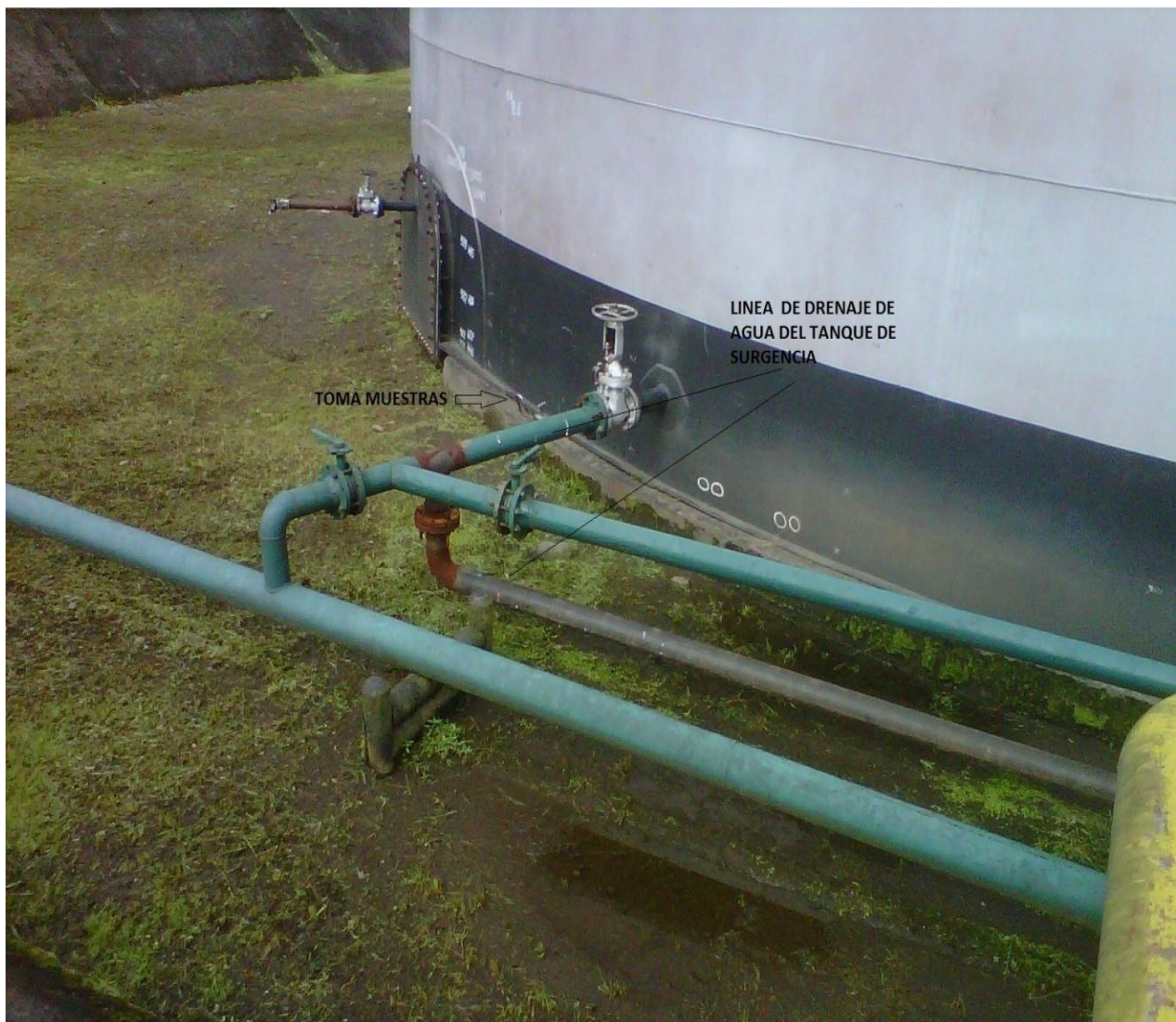
Figura 3.20 - Drenaje del Tanque de Surgencia
