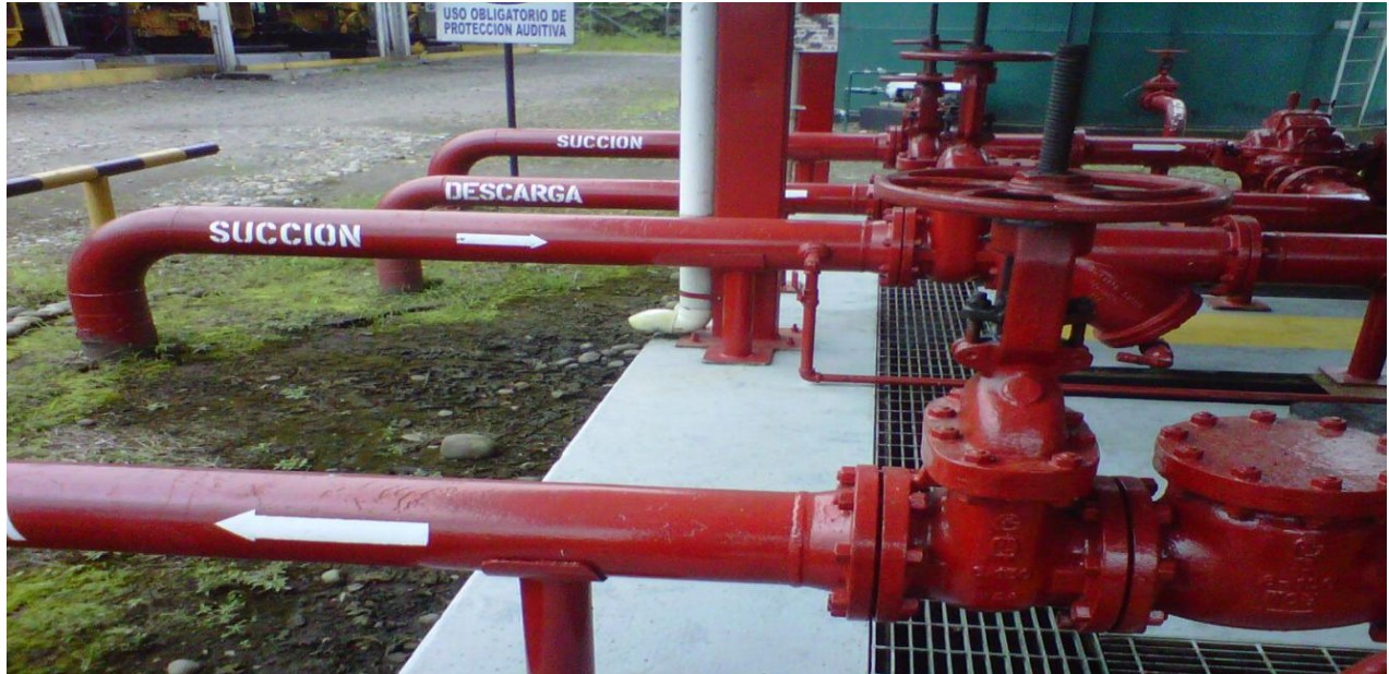
Figura 3.44 –Tuberías de Succión y Descarga
