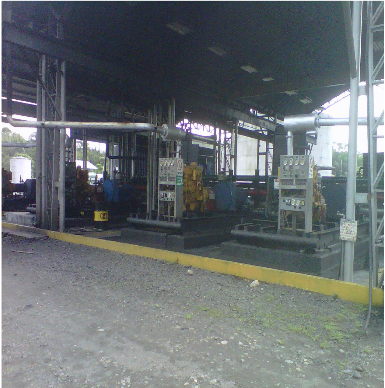
Figura 3.24 Unidades Power Oil
