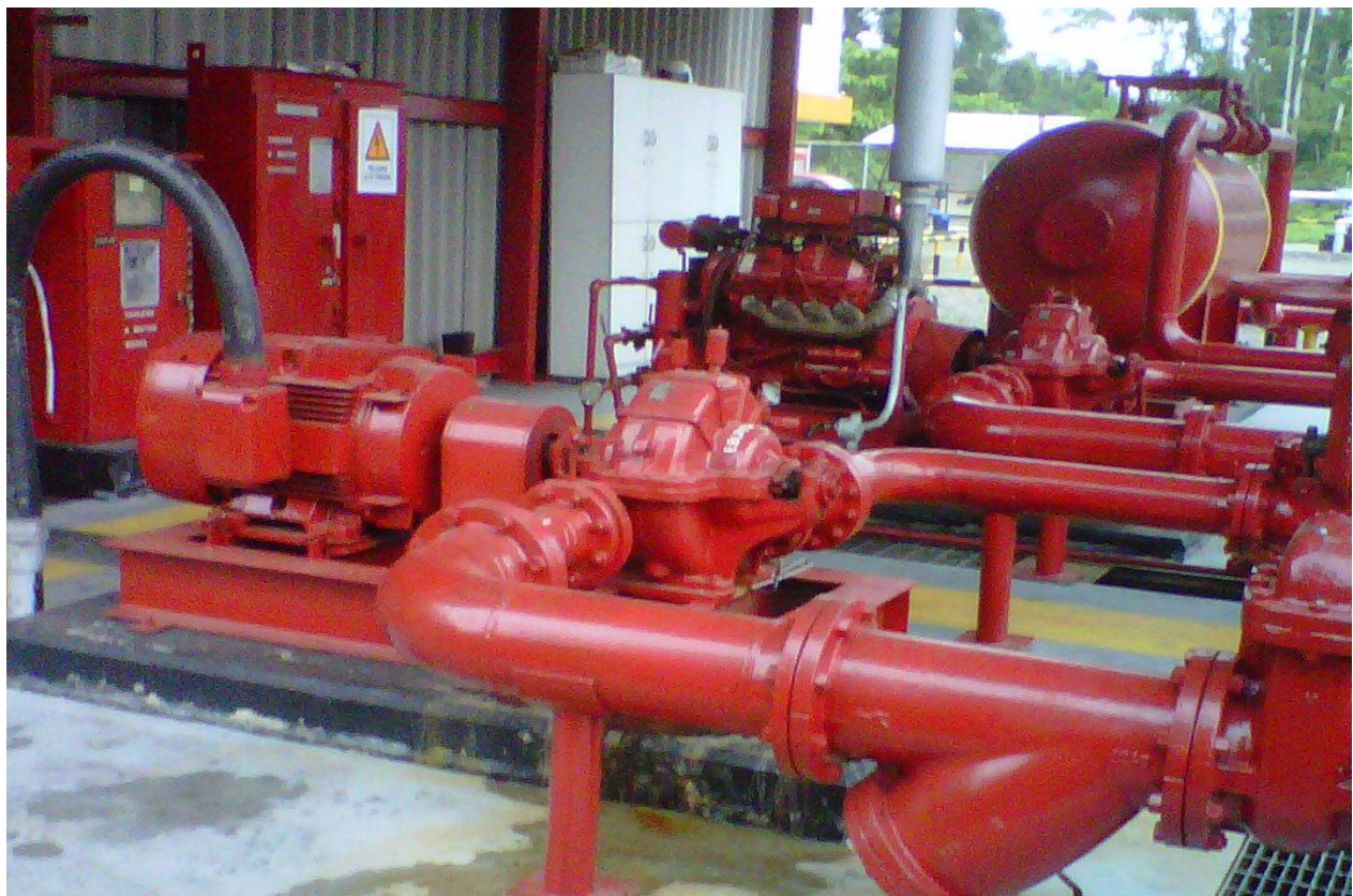
Figura 3.41 Motores y Bombas del Sistema Contra Incendios
