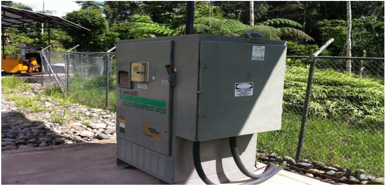
Figura 3.52 – Tablero del HPS
