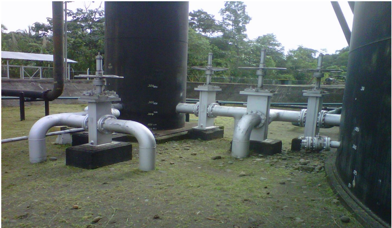
Figura 3.18 - Válvulas de entrada Tanque de Lavado
