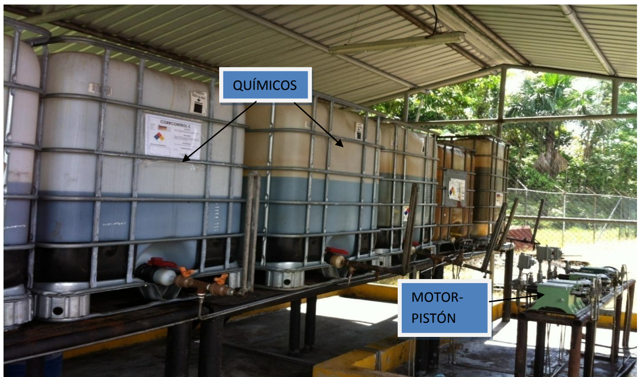
Figura 3.58 –Químicos Sector del Manifold
