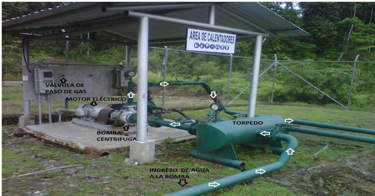
Figura 3.56 –Bomba de Recirculación de Agua del Tanque de Lavado
