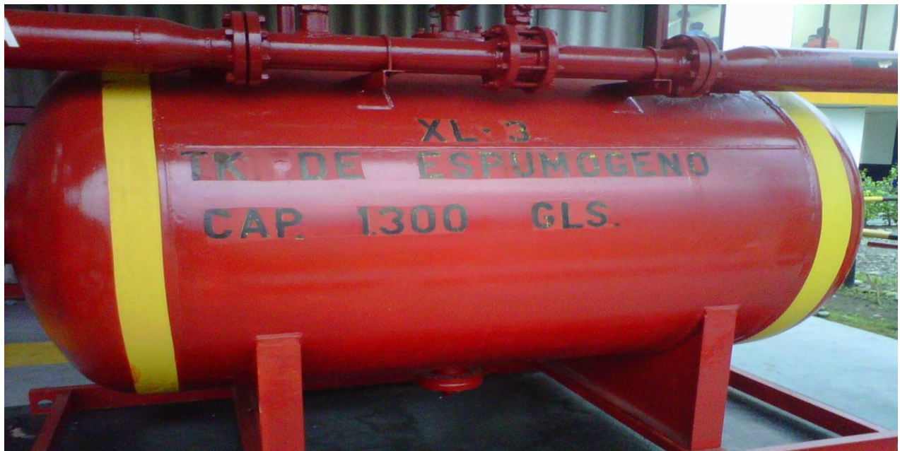
Figura 3.45 –Tanque de Espumogeno
