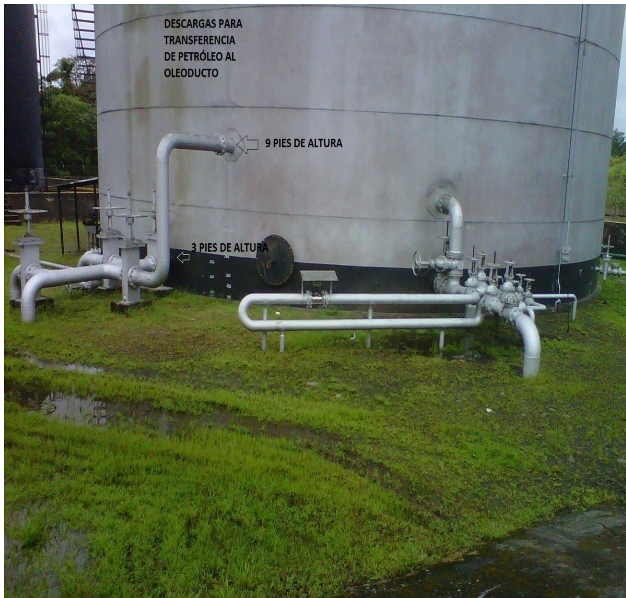
Figura 3.30 Descarga del Tanque de Surgencia para Transferencia de Petróleo
