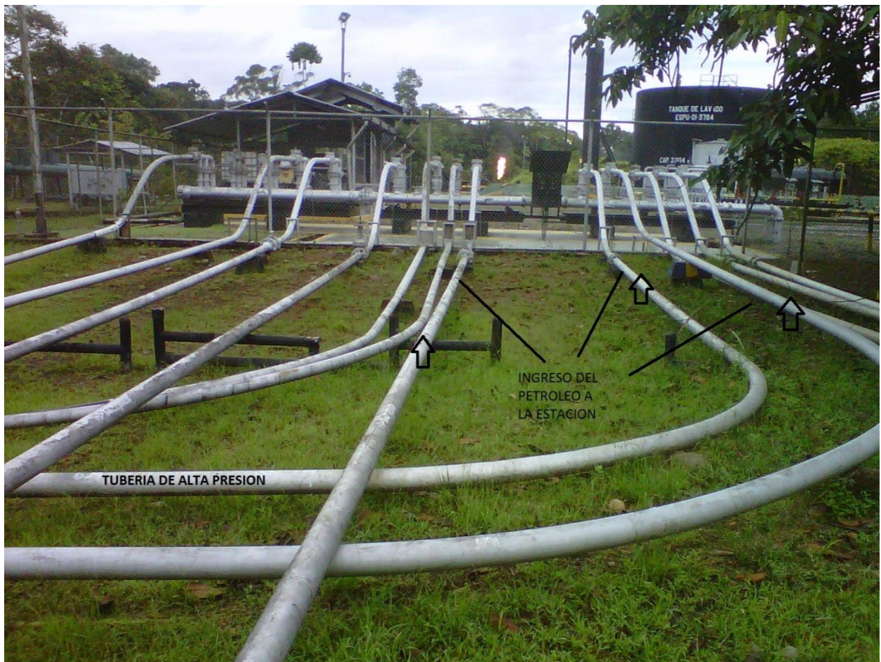
Figura 3.1 - Ingreso del petróleo a la estación
