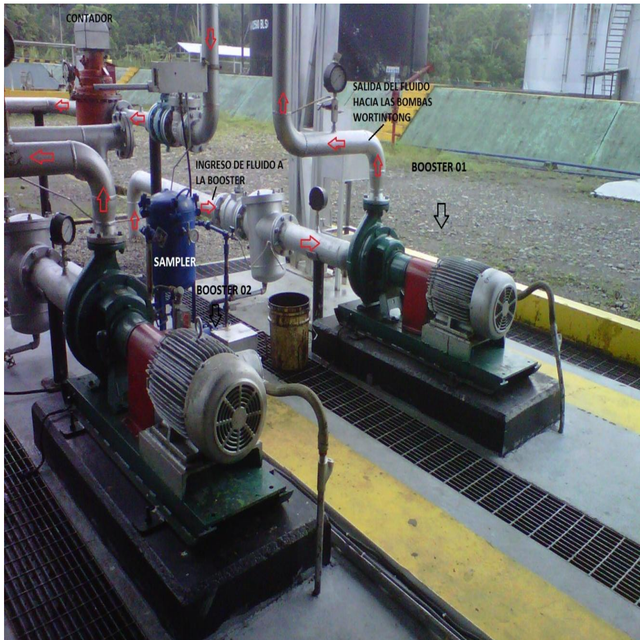
Figura 3.31 -Sistema de Transferencia de Petróleo (Booster)
