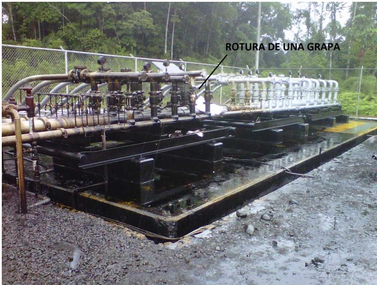
Figura 3.4. - Mala manipulación de válvulas
