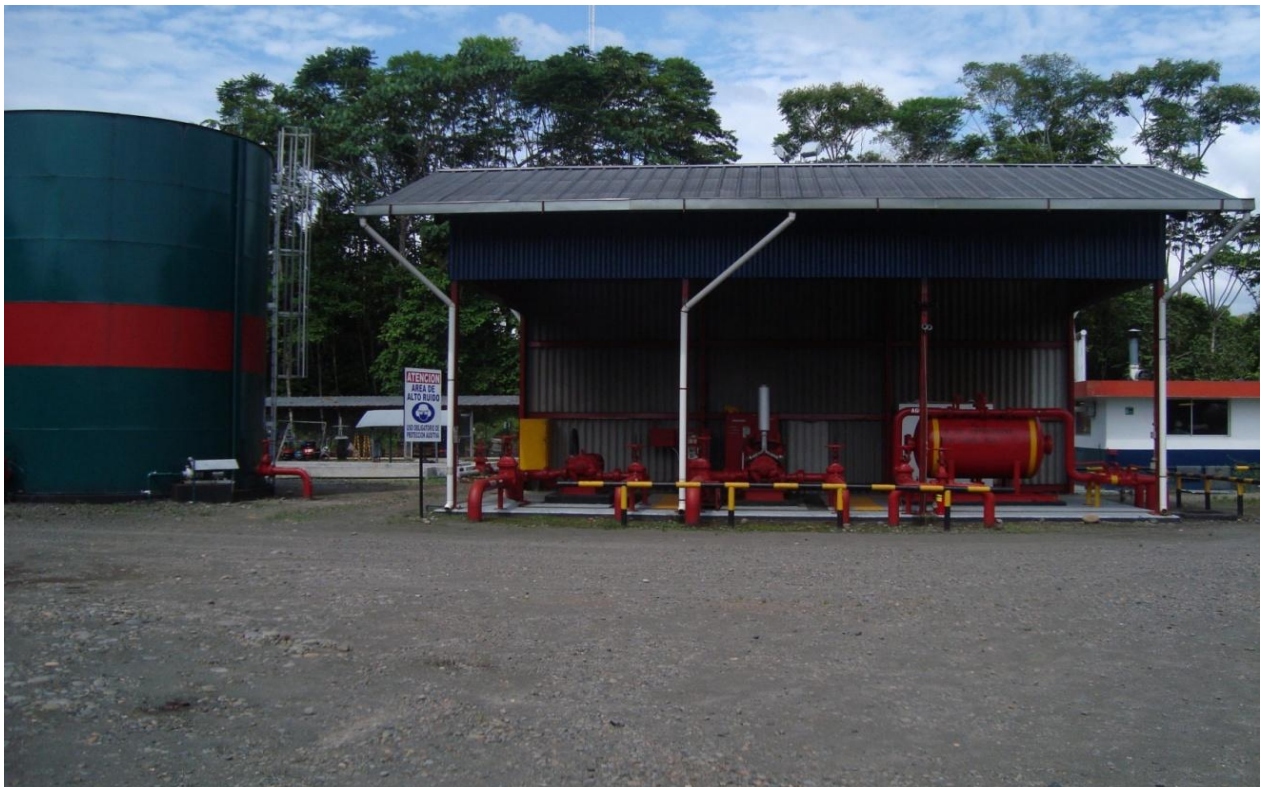
Figura 3.40 Tanque y Bombas
