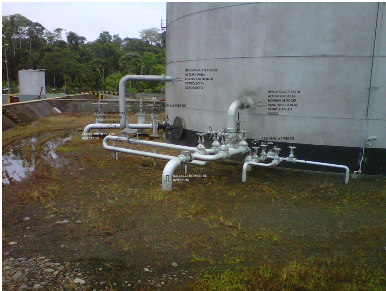
Figura 3.21 Válvulas de salida de petróleo del Tanque de Surgencia
