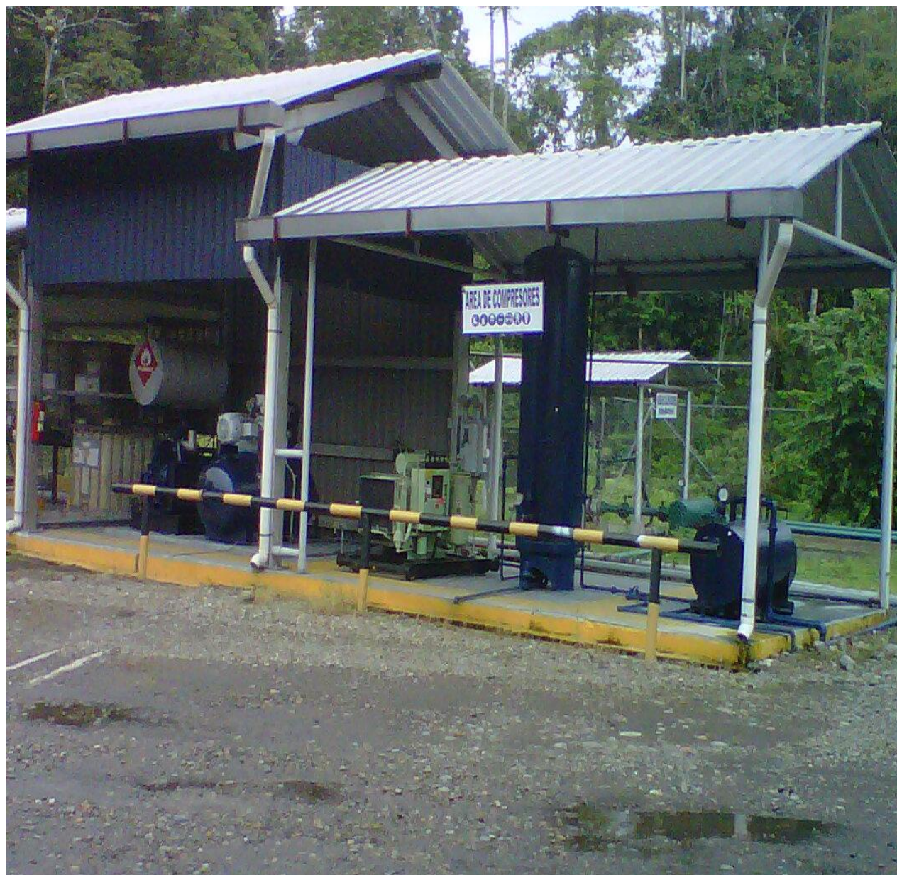
Figura 3.47 –Compresores de Aire
