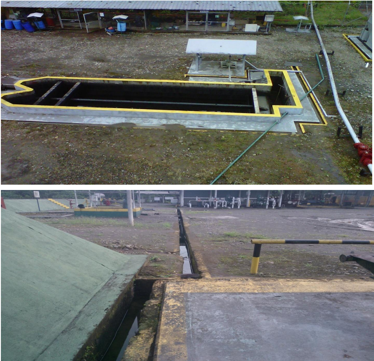
Figura -3.50 Piscina API y Canales de Evacuación de Aguas de Lluvia
