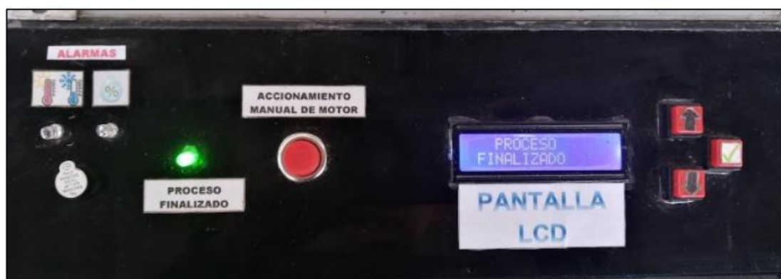
Figura 61. Panel de control finalización del proceso
