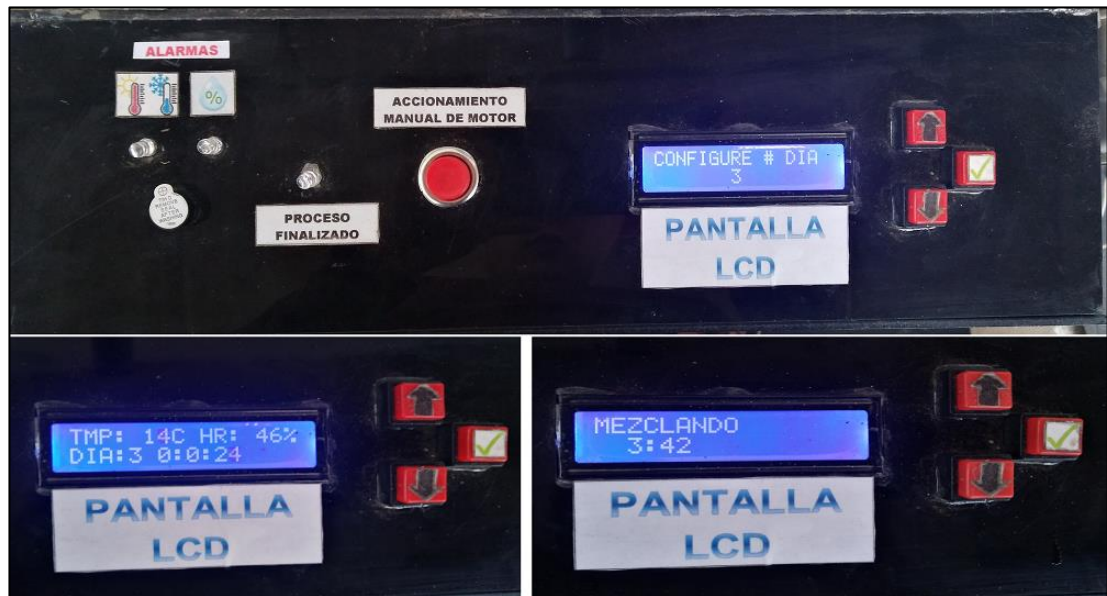
Figura 59. Panel del tablero de control
