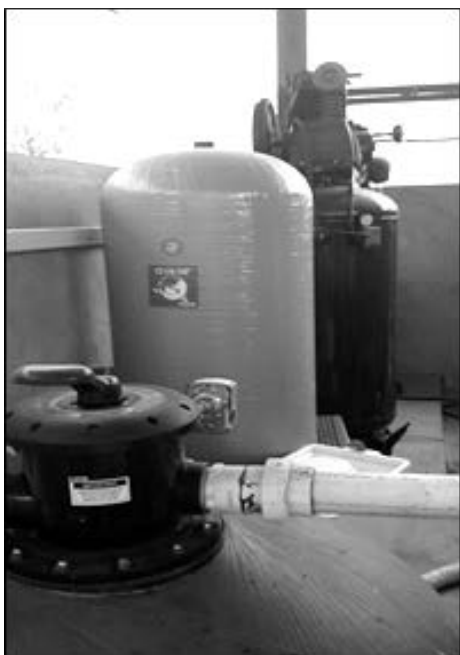
Fig. 13. Bombas para la distribución de agua.
