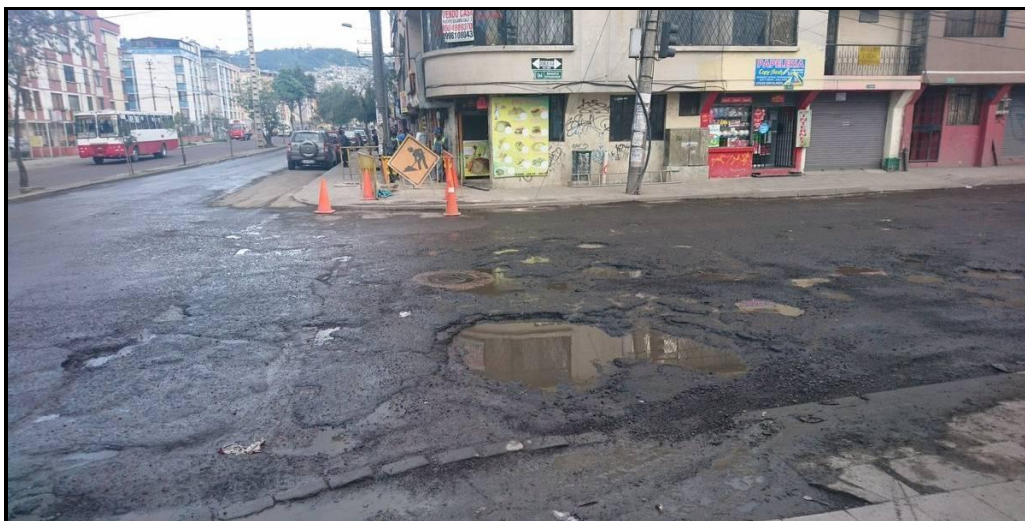
Figura 37. Estado de muchas vías en la ciudad de Quito (Diario Metro,2018)
