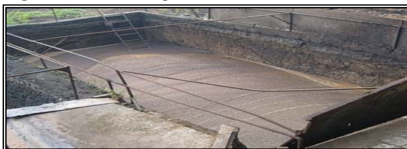
Foto N° 14 Laguna de tratamiento prioritario de ACEITPLACER.
