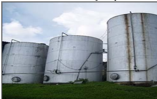
Foto N° 13 Tanques de almacenamiento de aceite rojo de palma de ACEITPLACER.
