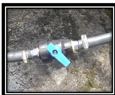
Figura 11 Llave de paso para regular la entrada y salida de agua
