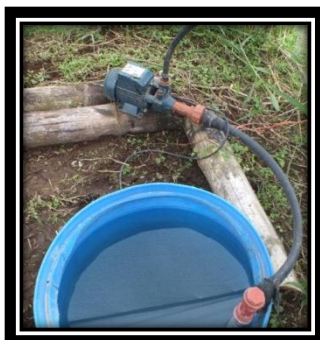
Figura 12 Instalación de electrobomba
