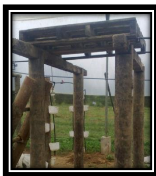
Figura 7 Soporte de madera para los tanques elevados
