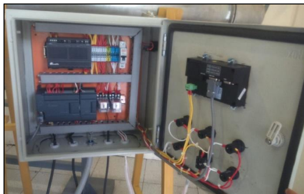
Figura N° 85 Conexión de conductores en el tablero de control
