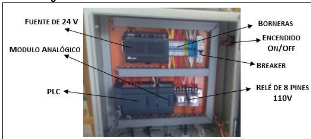
Figura Nº 89 Distribución interna del tablero eléctrico
