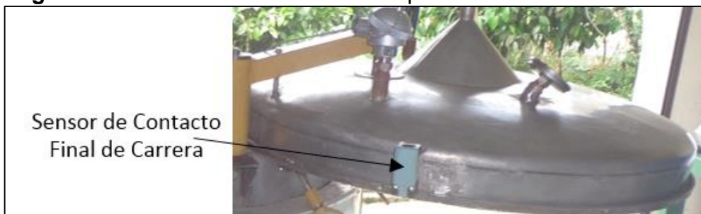
Figura N° 93 Final de carrera de la tapa de extractor de aceites
