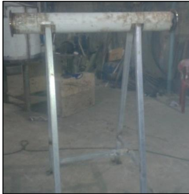
Figura N° 74 Base del Intercambiador de calor
