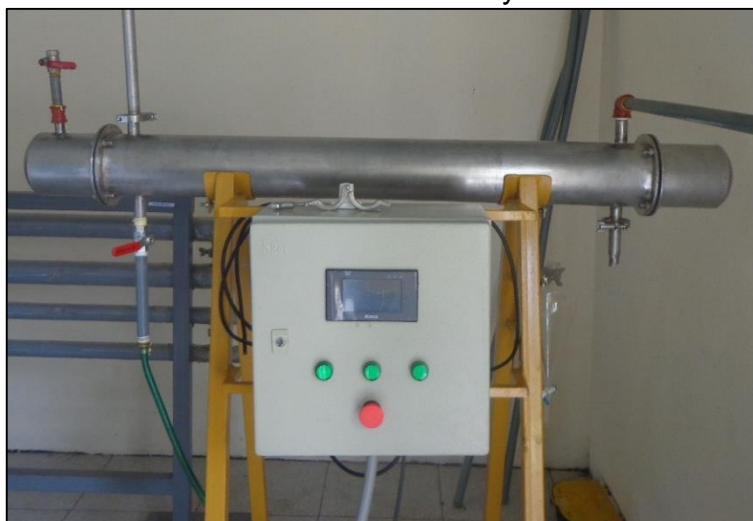
Figura N° 73 Intercambiador ubicado y armado en el soporte
