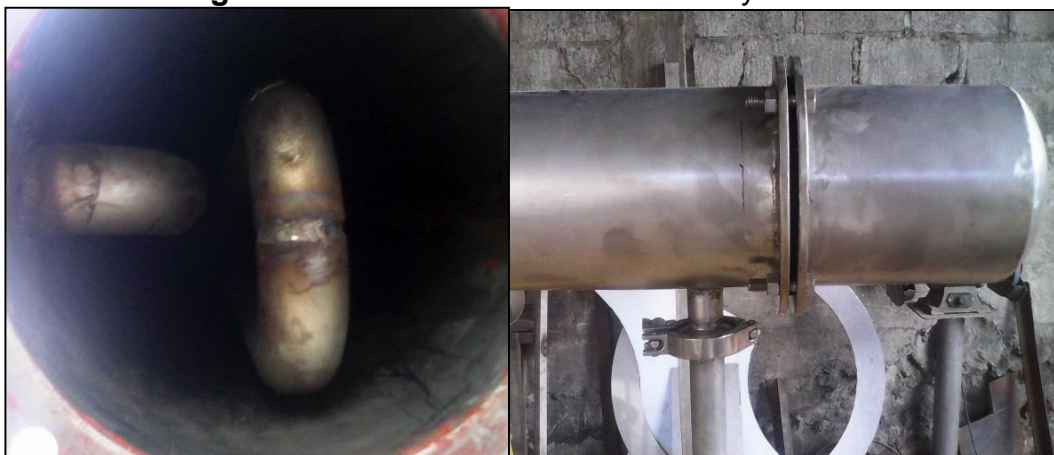
Figura N° 72 Intercambiador de Calor y recubrimiento
