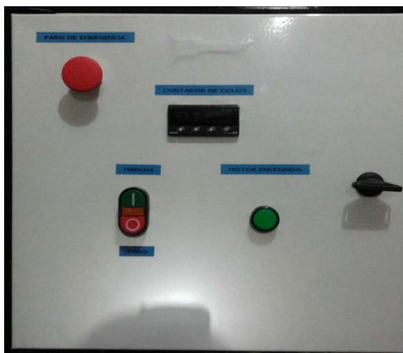
Figura 4.10 Exterior del tablero de control
