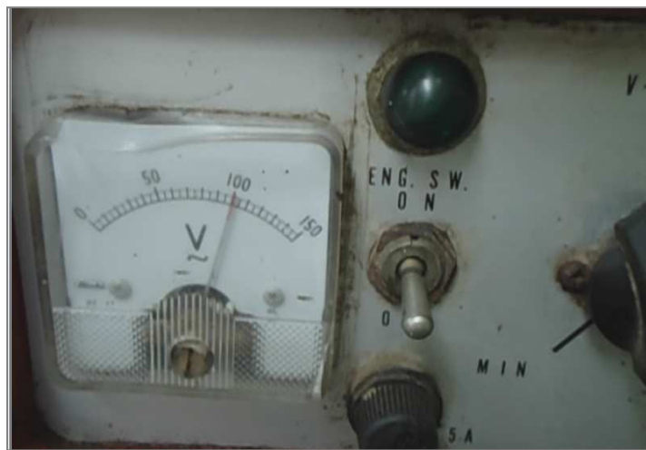
Figura 4-20 Tablero del generador
