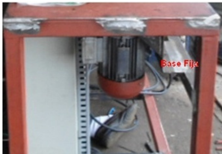
IMAGEN 4.71 FUNCIONAMIENTO MOTORES DE ELEVACIÓN
