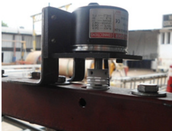
IMAGEN 4.55 MONTAJE DE ENCODER
