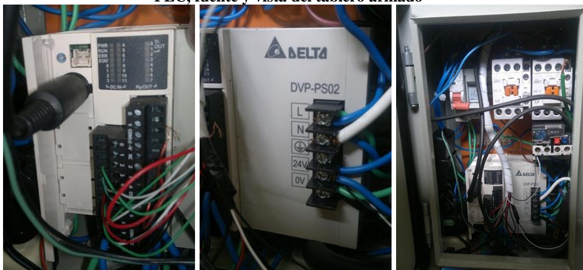
Figura 4.36 PLC, fuente y vista del tablero armado
