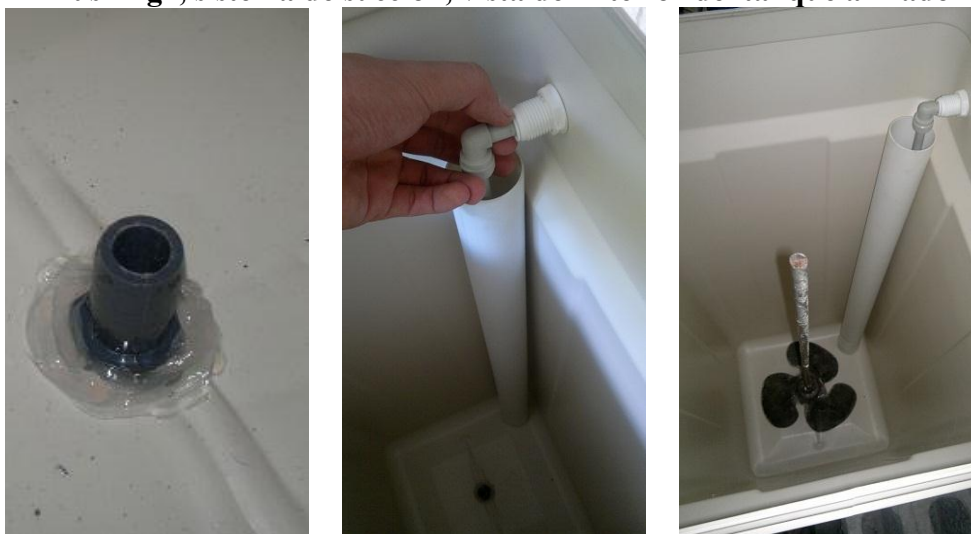
Figura 4.24 “Bushing”, sistema de succión, vista del interior del tanque armado
