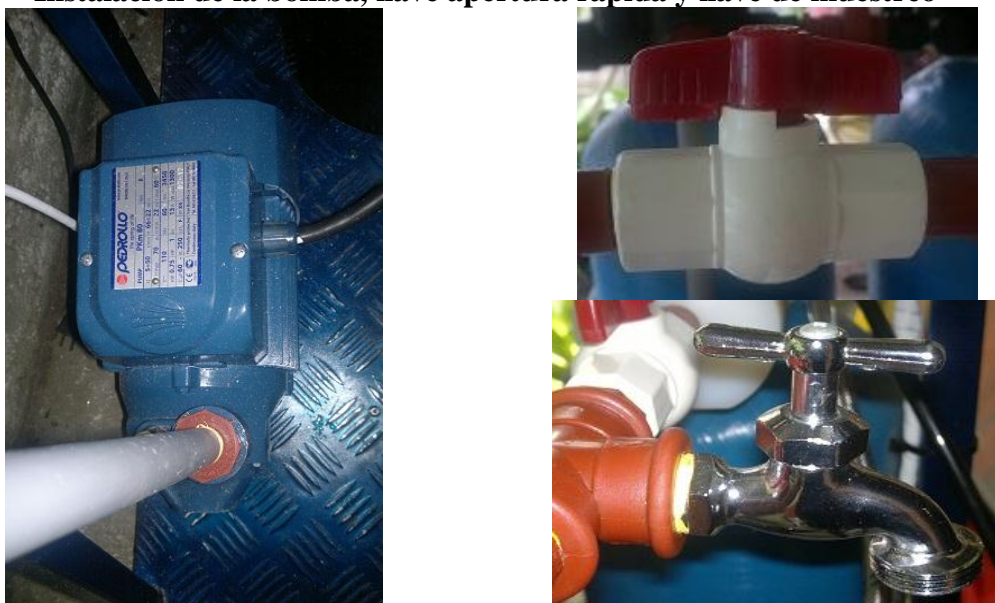
Figura 4.27 Instalación de la bomba, llave apertura rápida y llave de muestreo
