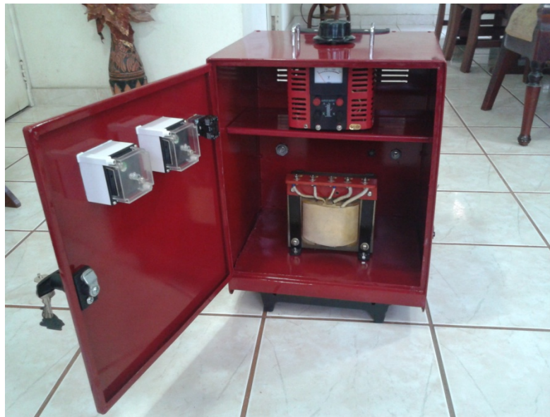
FIGURA 5-12 INSTALACIÓN DE DISPOSITIVOS DE MEDICIÓN Y CONTROL
