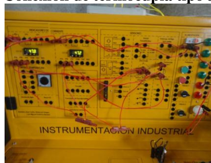
Figura 4.120 Conexión de termocupla tipo J
