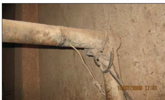
Figura 2-5: Salida del Transformador al riel
