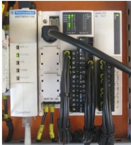
Figura 5-25: PLC y módulos
