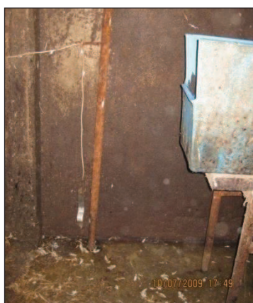
Figura 2-6: Salida del Transformador a la tina
