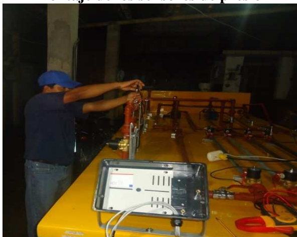
Figura. 4.11 Montaje de los sensores de presión
