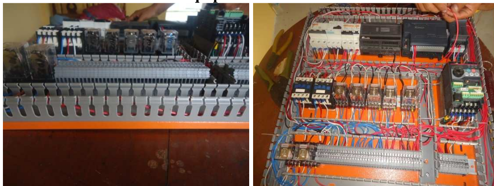
Figura. 4.12 Ubicación de los equipos dentro del tablero de control
