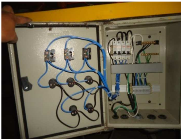
Figura. 4.3 Tablero eléctrico existente
