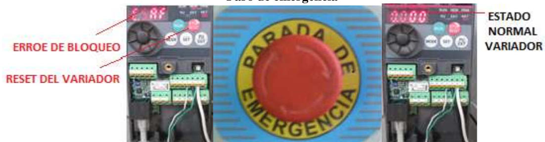
Figura. A.14 Paro de emergencia
