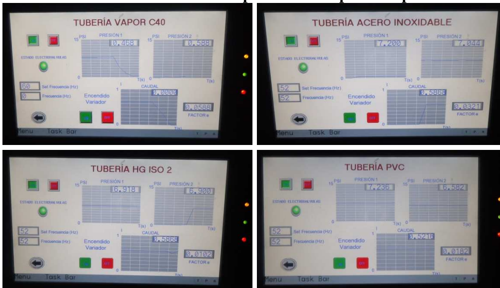
Figura. 4.15 Visualización de valores en la pantalla HMI pérdidas primarias
