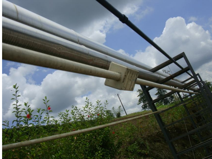
Figura 3.4 Tubería de Protección del Cable Belden para la red CC-Link
