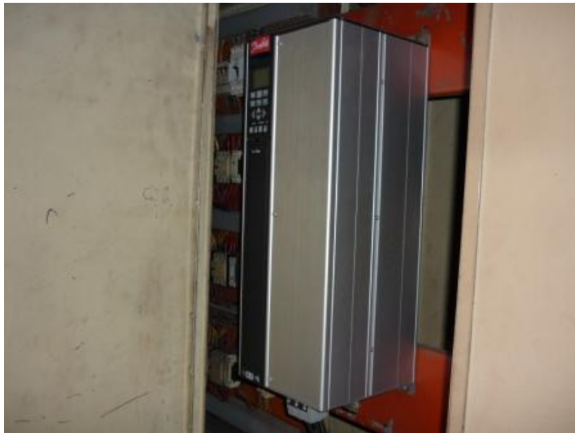
FIGURA 3.8 Variador de frecuencia de Inyector de aire caliente
