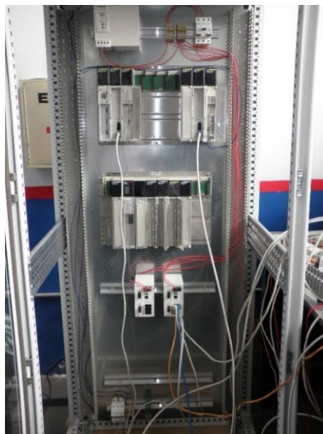
Figura 21. PLC de campo & PLC de Laboratorio de Pruebas.
