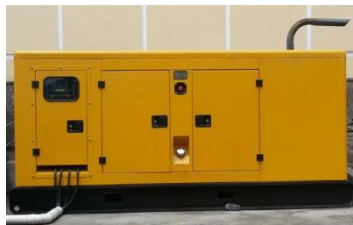
Figura 11. Planta de energía eléctrica Elaborada por: Energy Plam
