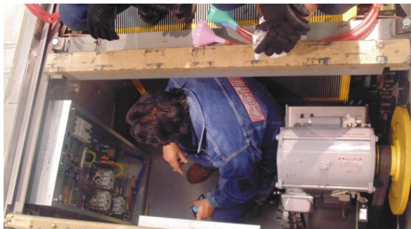
Figura 66. Mantenimiento de contactores y control. Elaborado por: el autor (2015)
