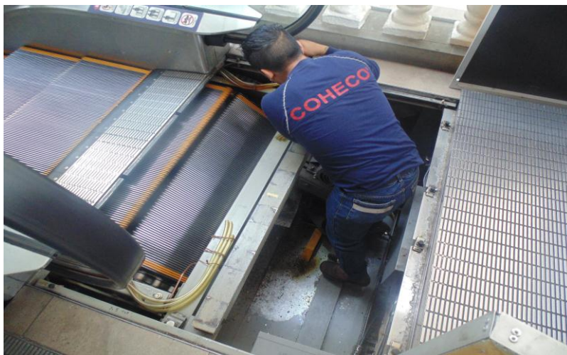
Figura 75. Lubricación de escalera mecánica. Elaborado por: el autor (2015)
