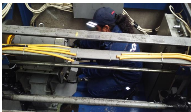
Figura 60. Mantenimiento del freno electromagnético. Elaborado por: el autor (2015)
