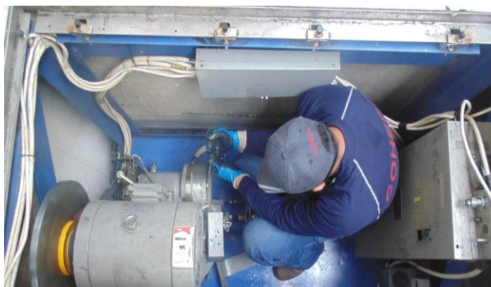
Figura 54. Mantenimiento del freno electromagnético. Elaborado por: el autor (2015)
