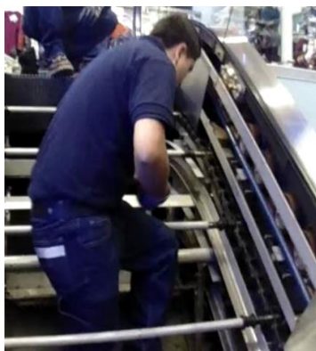
Figura 20. Mantenimiento de Escalera Mecánica. Elaborado por: el autor (2015)
