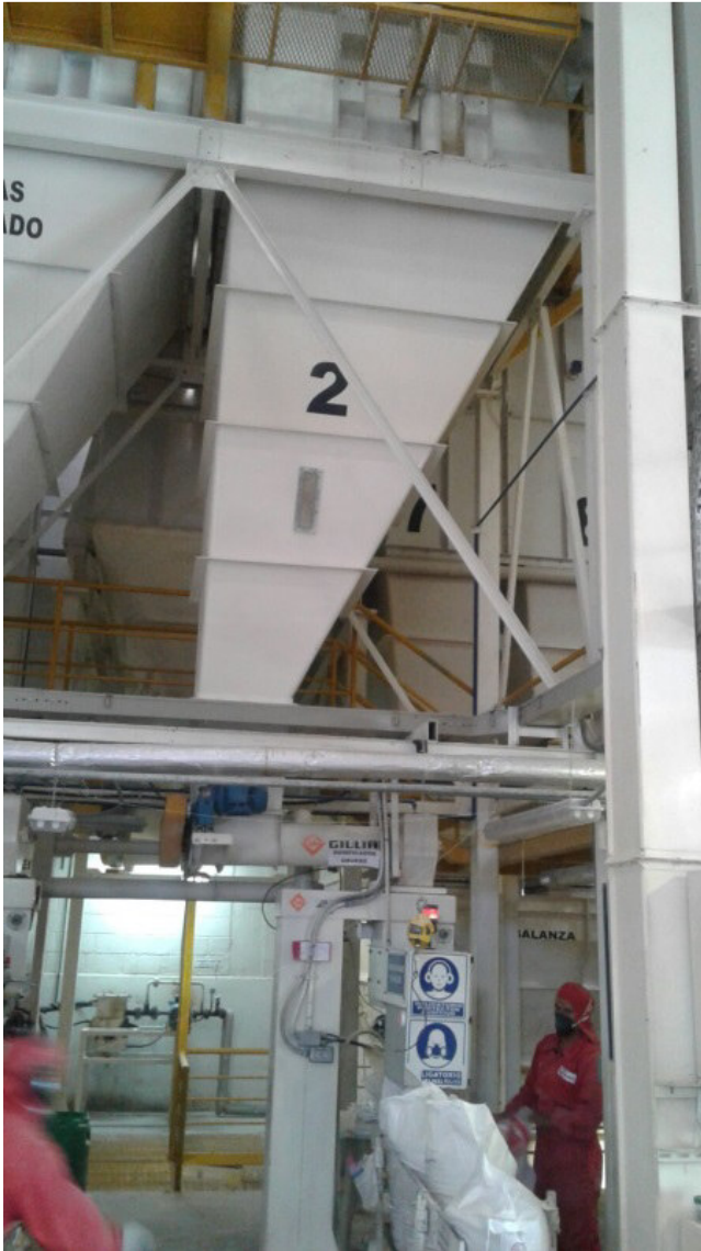
Figura 14: Tolva de la peletizadora donde se genera ruido con el movimiento interior de los pelets
