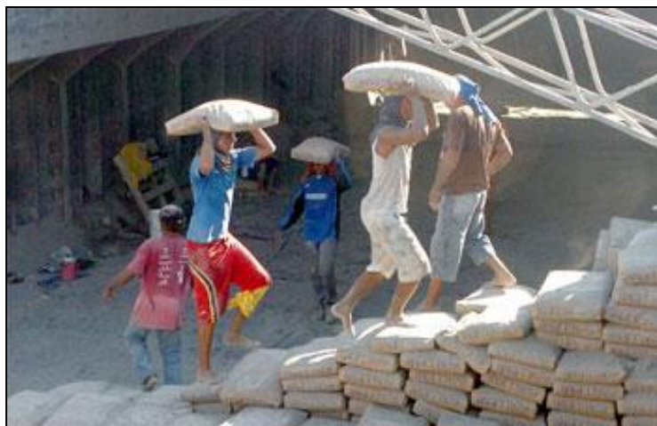
Figura 7. Levantamiento de sacos de cemento incorrecto
