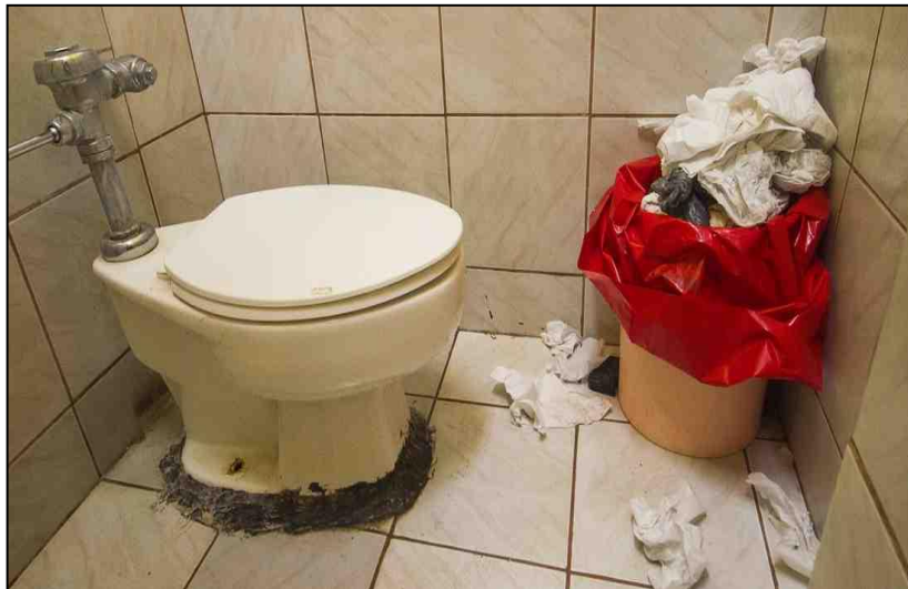
Figura 4. Condiciones de higiene inapropiadas en servicios higiénicos
