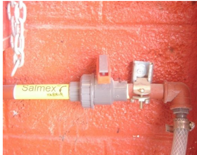
Figura 15. Tubería y válvulas de transporte del aditivo Fuente: Planta de Alimentos Puenbo
