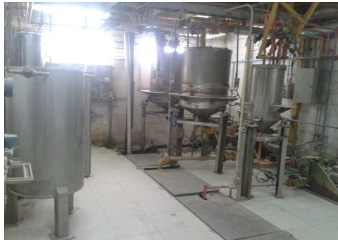
Figura 16. Tanques de almacenamiento de líquidos Fuente: Planta de Alimentos Puenbo
