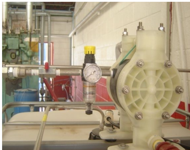
Figura 14. Bomba de dosificación aditivo. Fuente: Planta de Alimentos Puenbo
