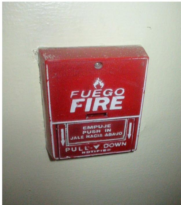
Foto No. 1: pulsador de alarma
