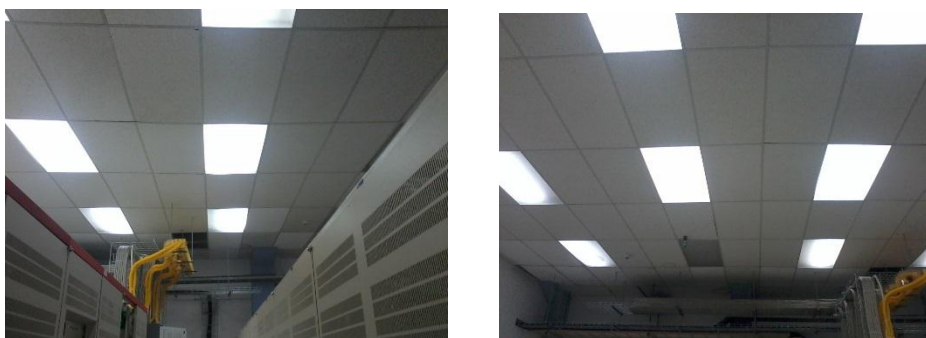
Figura No. 28 Cielo raso instalado bajo la loza de la central telefónica.
