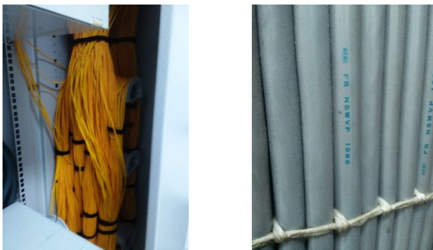
Figura No. 15 Cableado de conexión al interior de la central telefónica
