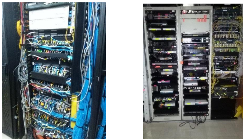
Figura No. 16 Equipos de telecomunicaciones instalados sobre racks
