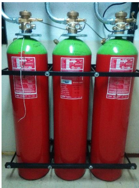
Figura No. 24 Tanques de agente limpio (FM 200) de sistemas de extinción automática.
