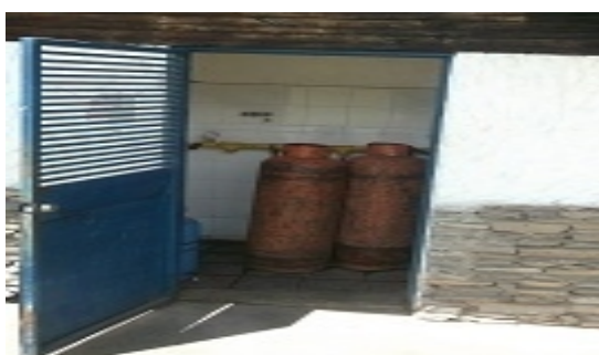
Figura 31 Bodega de sistema gas GLP empresa florícola
