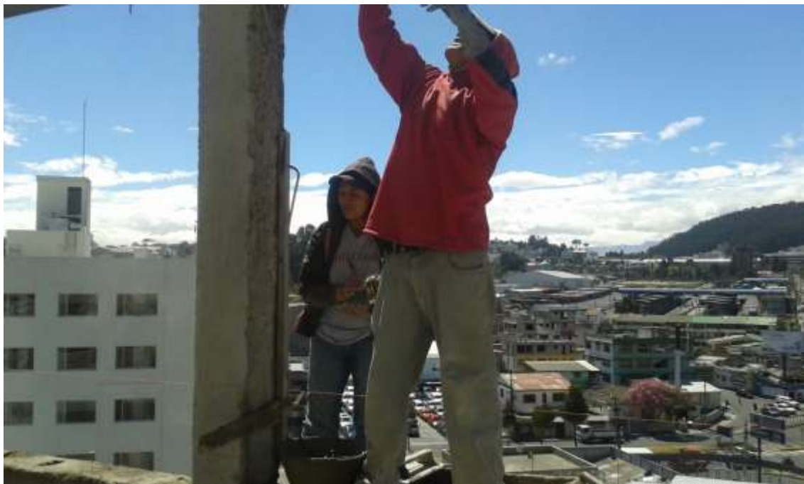
FOTOGRAFIA N° 9: Hombre Albañil realizando tareas de picado en viga exterior en altura (albañilería) Foto tomada por: William Jácome Terán
