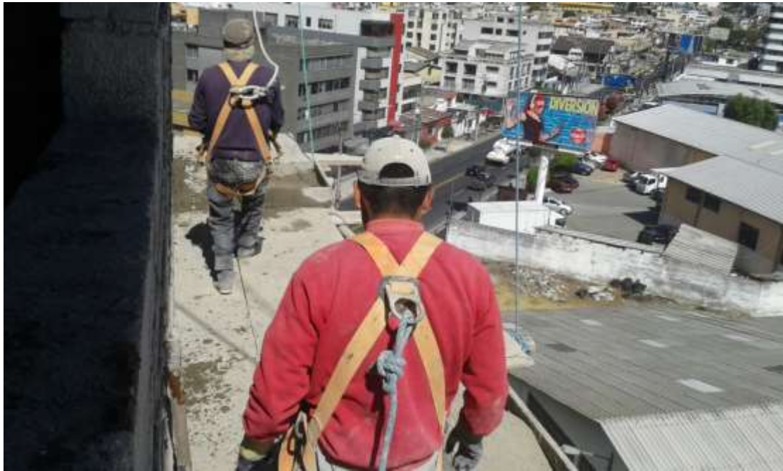
FOTOGRAFIA N° 8: Hombre Albañil realizando tareas de enlucido en exterior (albañilería) Foto tomada por: William Jácome Terán
