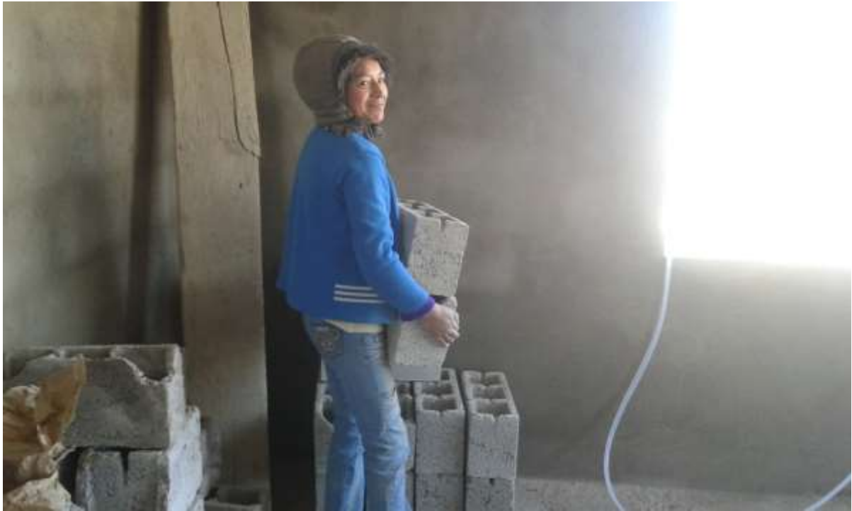
FOTOGRAFIA Nº 2: Mujer Peón realizando tareas de traslado de bloque / apoyo al trabajo del albañil.
