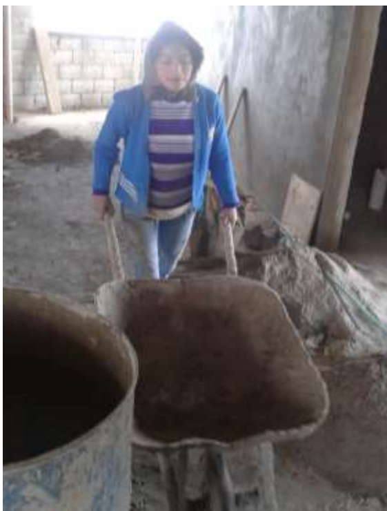
FOTOGRAFIA N° 15: Mujer peón realizando trabajos de acarreo de materiales (albañilería) Foto tomada por: William Jácome Terán
