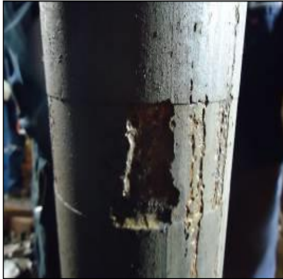
Figura 4. Corrosión por Lixiviación selectiva en equipo BES
