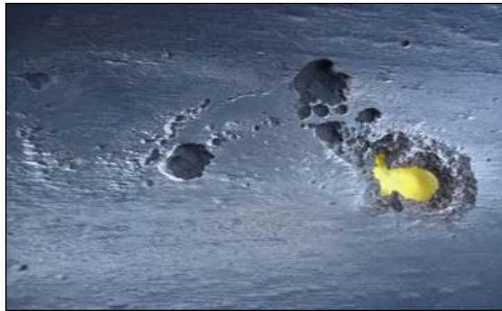
Figura 3. Corrosión por picadura
