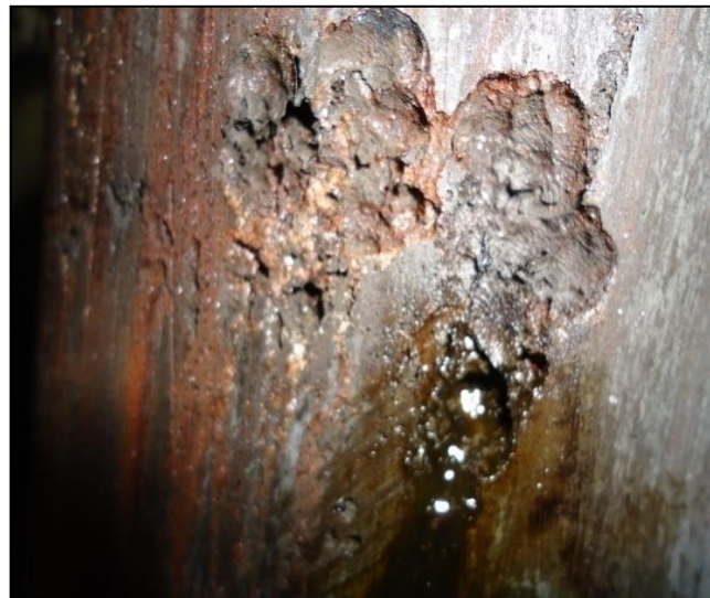
Figura 5. Corrosión galvánica en equipo BES
