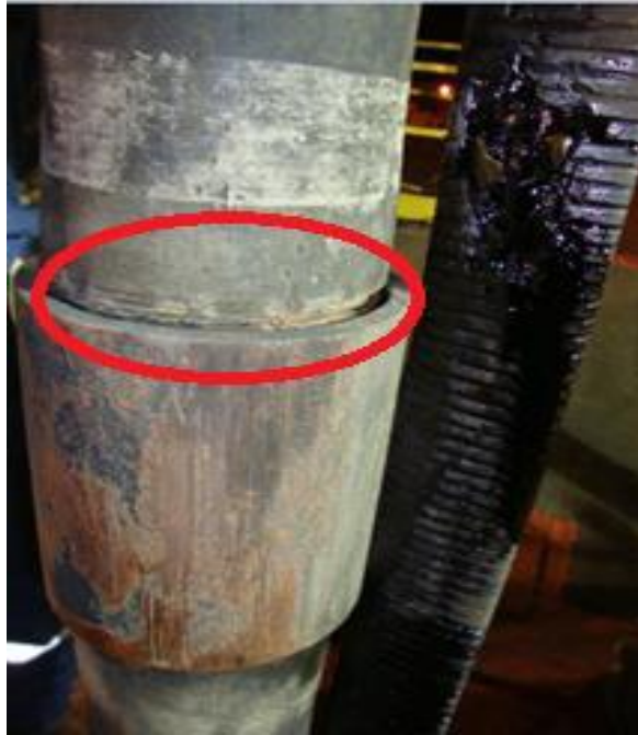
Figura 48. Corrosión en los pines de la tubería
