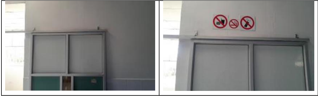
Figura 18. Colocaciones de Señaléticas
